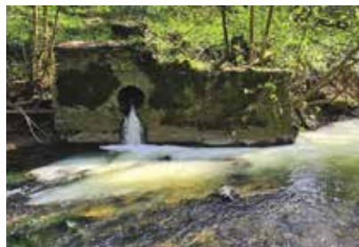
Le rejet d'Eaux Pluviales à Brunoy où a été constatée la pollution
