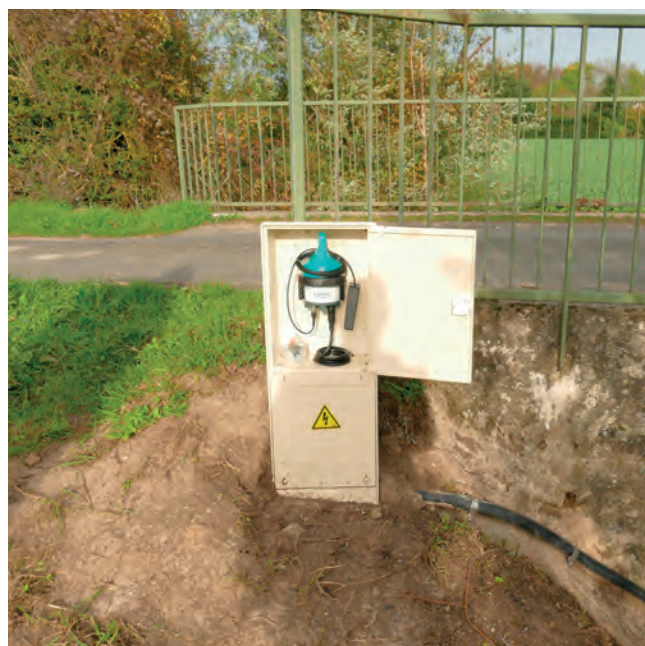
26. Des sondes piézométriques ont été installées à l'amont
